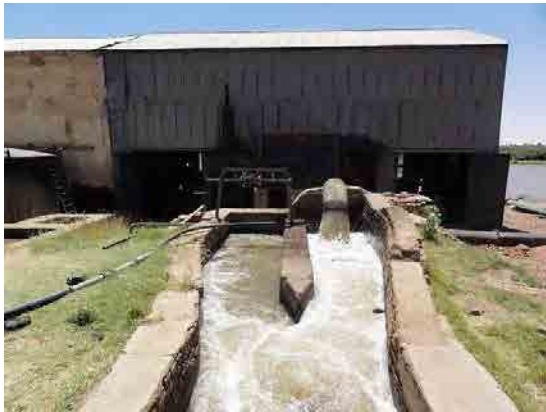
写真-3: アリアブポンプ場 建設後 39 年以上経過しており、ポンプも老朽化が進んでいる。早急なりハビリテーションが必要である。
