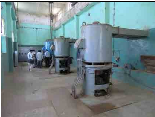
写真-5: K14 ポンプ場 建設後 37 年以上経過しており、ポンプ設備は劣化し効率も低下している。スペアパーツの入手が困難で維持管理に支障をきたしている。
