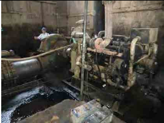
写真-1: キティアブポンプ場 建設後 65 年以上経過しており、老朽化が進み、メンテナンスにも限界がきている。
