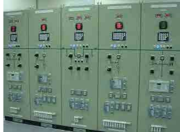
(d) 11 kV Switchgear
