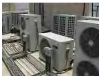
屋外機置場の様子
