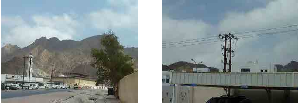
図 4-14 架空中圧配電線 (MEDC 設備)
