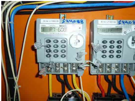
(a) 電気室内設置のデジタルメータ
