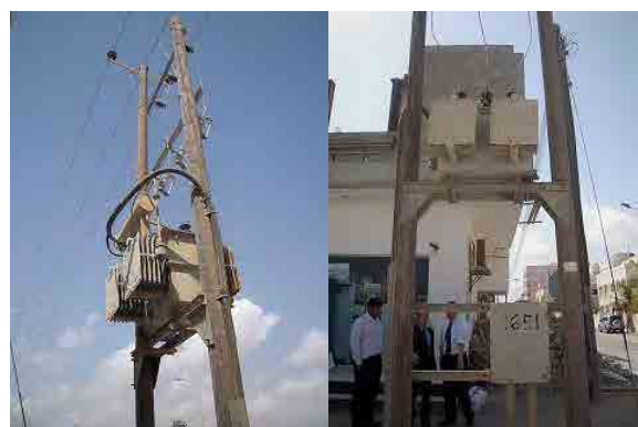
(b) 柱上設置型(315 kVA)
