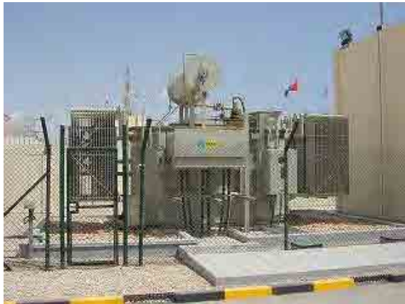
(c) 33/11kV 変圧器
