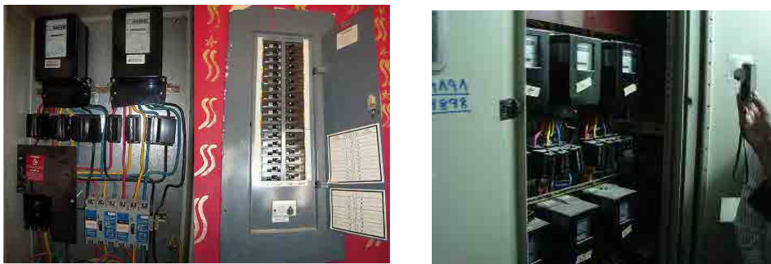
(a) 住宅用電力メータ設置箱と分電盤
