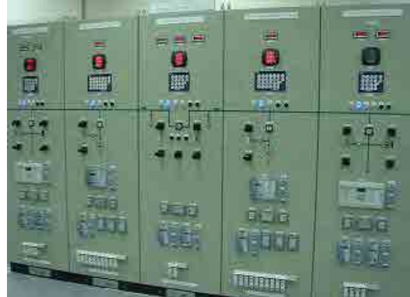
(d) 11kV スイッチギア
