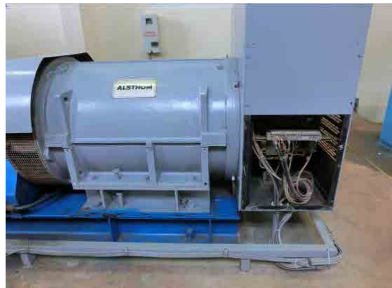
(11)オチュム第二発電所：発電機の状態 励磁機に経年劣化が見られ状態は極めて悪い。水車にキャビテーションが生じ磨耗を起こしている。
