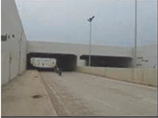
Nguồn: Đoàn nghiên cứu chụp Hình 3.1.30 Phân giao cắt với tuyến đường sắt quốc gia (vị trí 10k500m)
