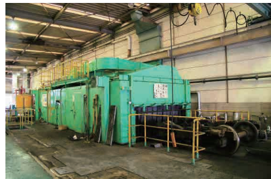
出典：調査団撮影 図 3.5.9 台車洗浄装置
