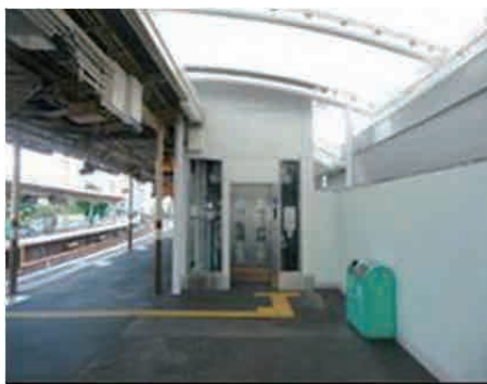
出典：調査団撮影 図 3.4.33 エレベーター
