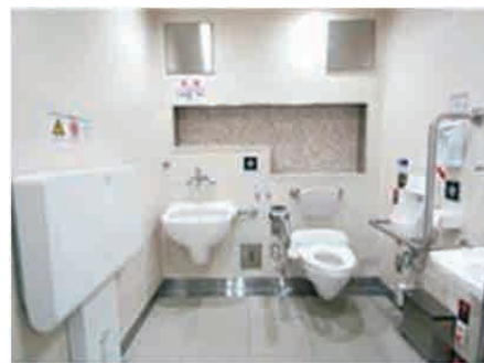
出典：調査団撮影 図 3.4.34 多機能トイレ
