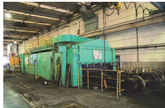
出典：調査団撮影 図 3.5.9 台車洗浄装置
