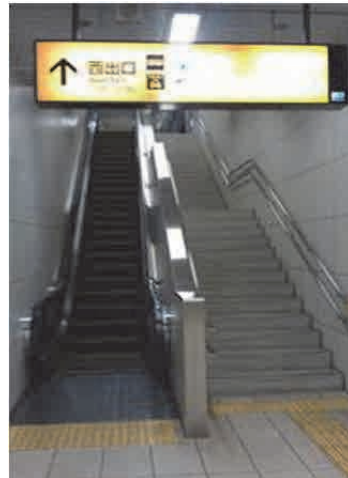
出典：調査団撮影 図 3.4.32 エスカレーター
