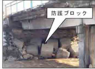
崩壊している橋台全面防護工
