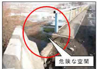
車の衝突により破損した高欄
