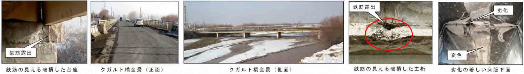
鉄筋の見える破損した台座
