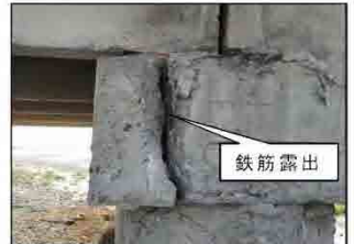
崩壊寸前の台座（要緊急補強）
