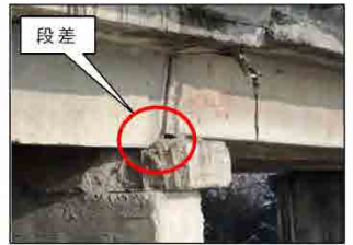
台座が破損し、主桁に生じた段差
