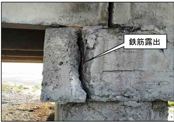
写真-5：崩壊寸前の橋脚台座部
