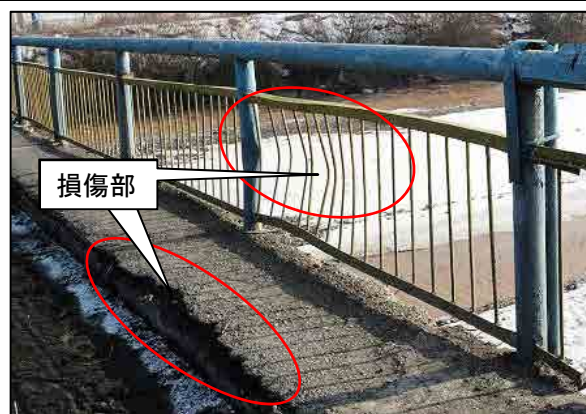
写真-10：損傷した歩道端部と高欄
