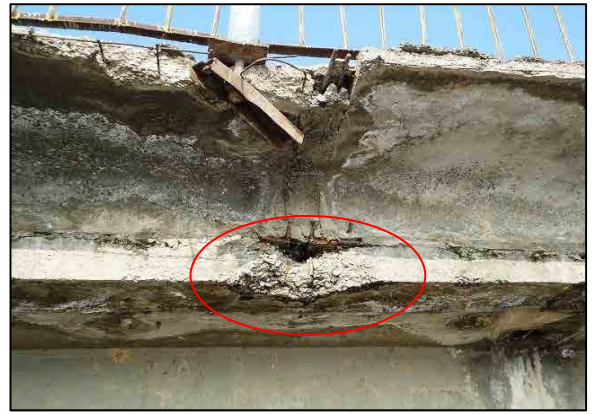
写真-4：洪水時に損傷した床版部
