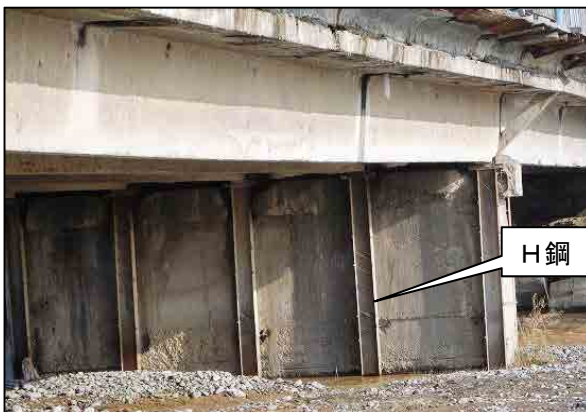
写真-7：落橋寸前の桁を支えているH鋼
