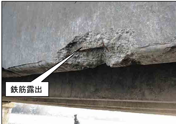
写真-3：洪水時に損傷した主桁
