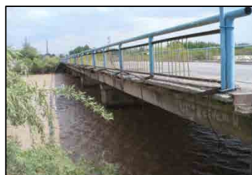
写真 2-2-23 光ケーブルの添架跡
