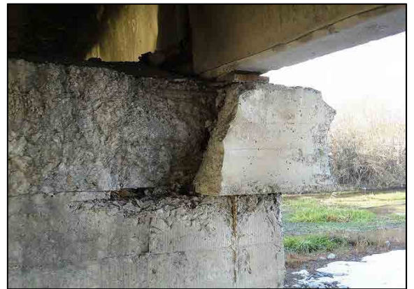
写真-6：損傷の著しい橋脚台座部
