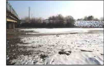
⑬ クガルト川下流の左岸堤防の状況
