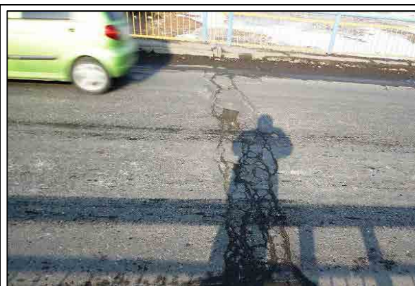
写真-9：ひび割れの著しい伸縮継手部
