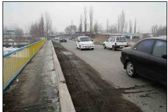
写真 2-2-20 橋面舗装に見られる損傷
