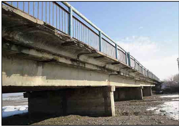
写真-1：老朽化・損傷の著しいクガルト橋
