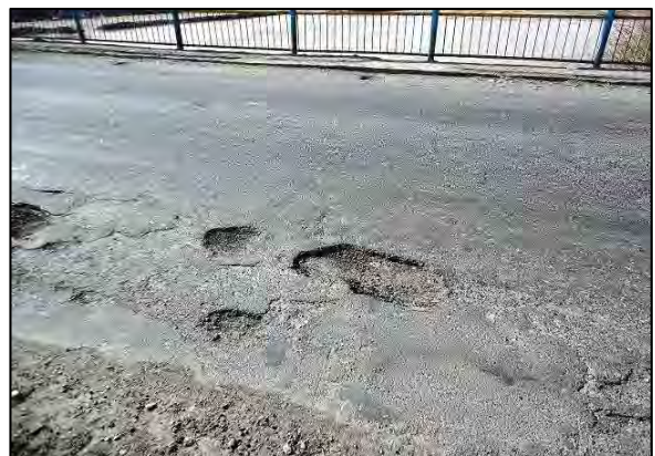
写真-8：劣化・損傷の著しい床版
