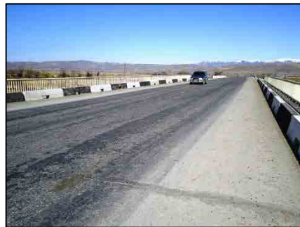
写真 2-2-16 擦り減りが見られる橋面舗装
