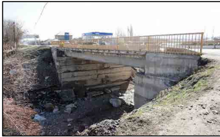
写真 2-2-5 劣化・損傷の著しいマシュラブセイ橋
