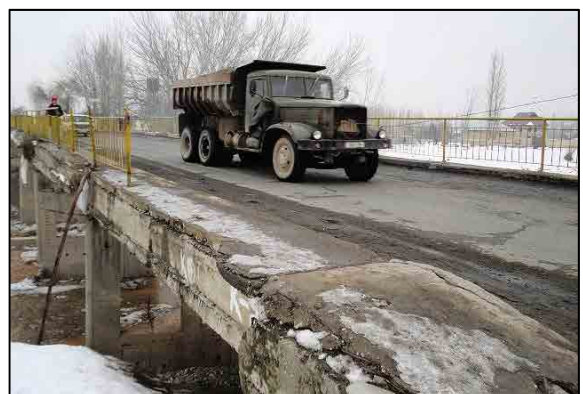
写真 2-2-22 舗装及び地覆の損傷・劣化が著しい
