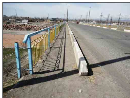
写真 2-2-18 擦り減りが多少見られる橋面舗装
