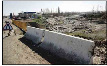
写真 2-2-6 護岸が崩壊しているマシュラブセイ川
