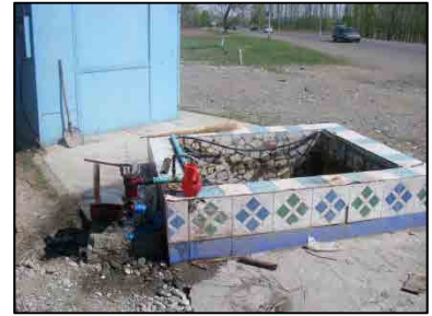
写真 2-2-19 サイトに設置された井戸
