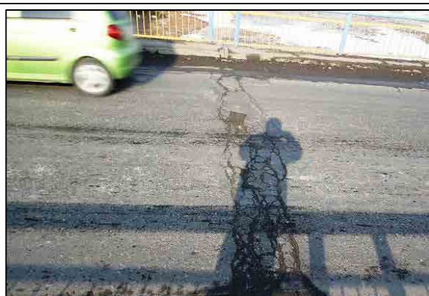
写真-9 : ひび割れの著しい伸縮継手部
