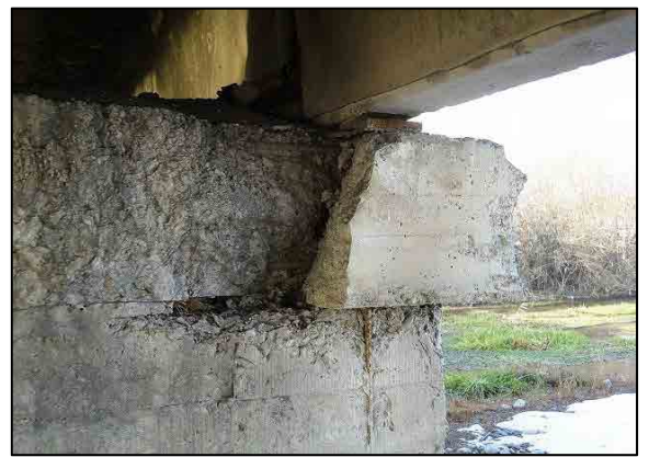
写真-6：損傷の著しい橋脚台座部
