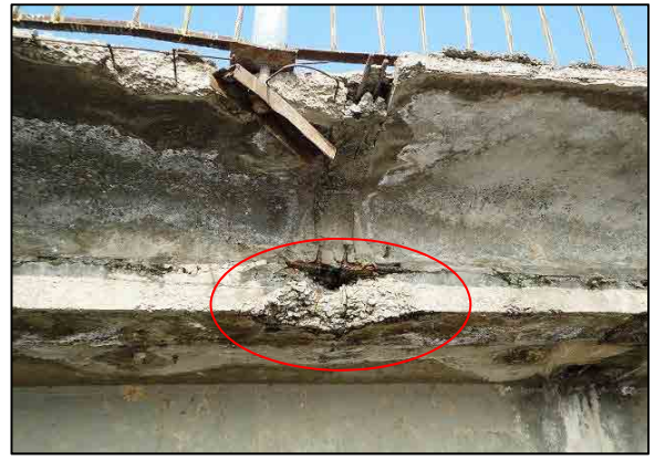
写真-4：洪水時に損傷した床版部
