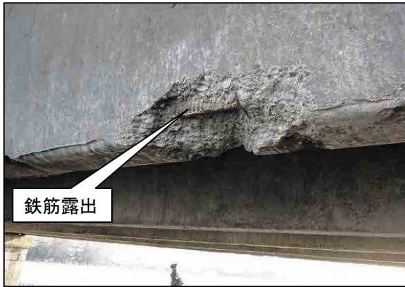
写真-3：洪水時に損傷した主桁
