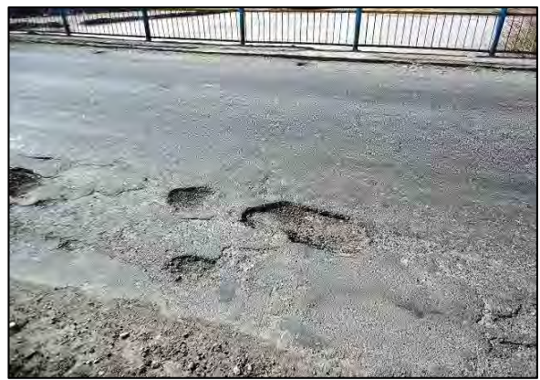
写真-8：劣化・損傷の著しい床版
