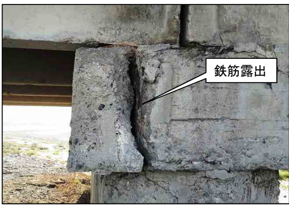
写真-5：崩壊寸前の橋脚台座部
