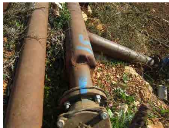
【写真-2：25 灌漑サイト/管路施設】
