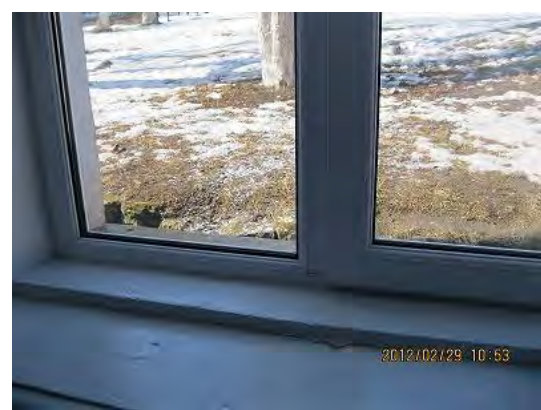
写真-4 : Orhei 県 Jora de Mijloc 村 保温性に優れた二重窓に更新されている小学校教室の窓。旧式の木枠製窓の学校施設もまだ多くある。
