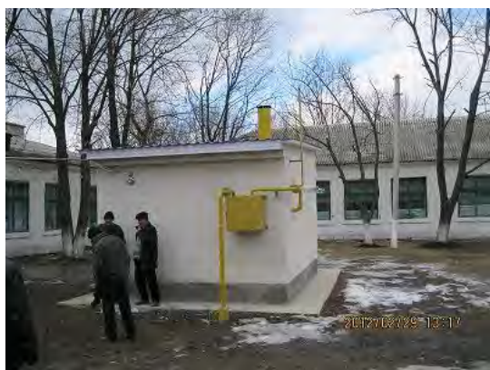
写真-1 : Orhei 県 Jora de Mijloc 村 幼稚園に暖房用温水を供給するガスボイラーハウス。出力 50kW のボイラーが 2 台設置されている。
