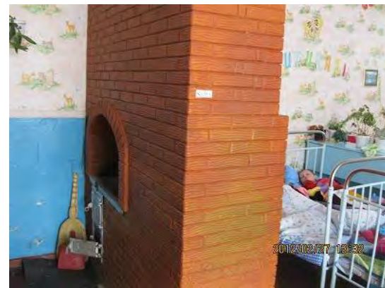
写真-10 : Orhei 県 Ivancea 村 幼稚園の暖房に使用されている古い石炭暖房施設（ストーブ）。石炭ストーブが幼児の昼寝用寝室にあり、室内空気環境を悪化させている。
