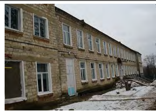
写真-6 : Orhei 県 Piatra 村 小学校校舎の外観。校舎の全ての窓が二重窓に更新されており、保温性が高い。評価も良い施設の一例である。
