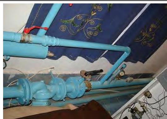
写真-5 : Orhei 県 Piatra 村 ガスボイラー室の温水配管。調達予定ペレットボイラーへ接続し利用することが可能。
