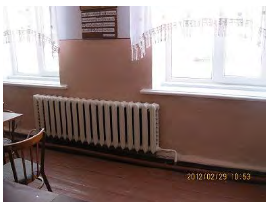
写真-3 : Orhei 県 Jora de Mijloc 村 小学校教室にあるラジエター。旧式のラジエターであるが、調達予定ペレットボイラーと接続して利用することが可能。
