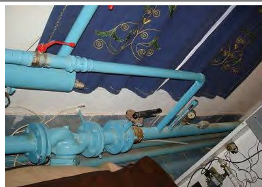
写真-5 : Orhei 県 Piatra 村 ガスボイラー室の温水配管。調達予定ペレットボイラーへ接続し利用することが可能。
