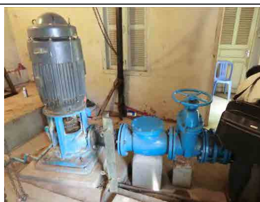
写真 2.1.4.1-2 既存取水施設の縦軸ポンプ
