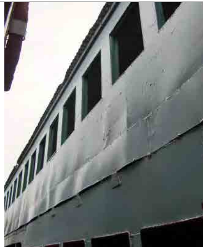
上部構造の外板接合部が断切し歪
