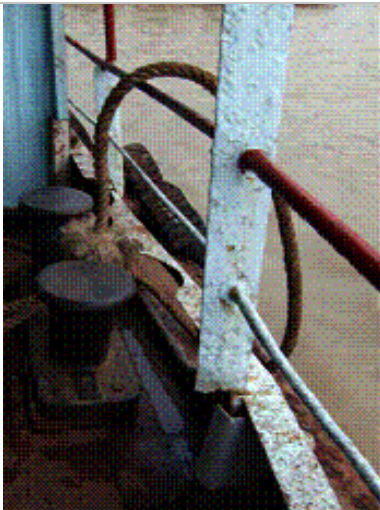
ハンドレール支柱が根部で断切
