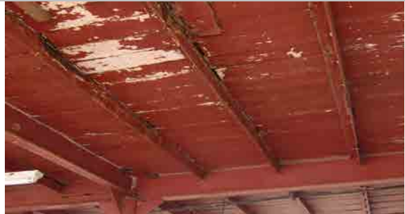
木製甲板を支える補強形鋼に錆、崩壊の恐れ
