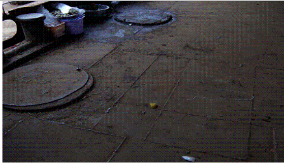
継ぎ接ぎの甲板と錆
