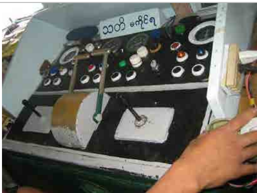
操舵室の操縦盤、主機スロットル、主軸クラッチ、操舵、舵角指示器のみ作動し、主機回転計、警報などほとんどの計器・装置は故障で危険
