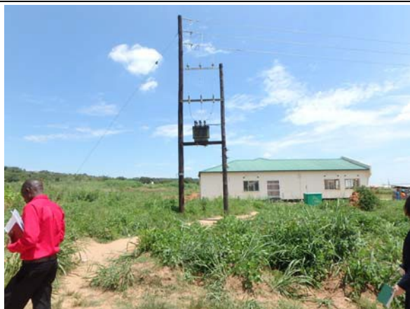
受変電設備・既存保健センター東側面 既存保健センターとの連携に配慮し、同センター裏手(写真左側)に計画施設を配置する。
