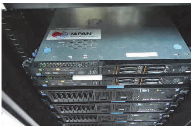
プロジェクトにより供与された機材 VEA内のサーバールームに設置され、VEA下のITC が保守担当(2013年5月17日)
