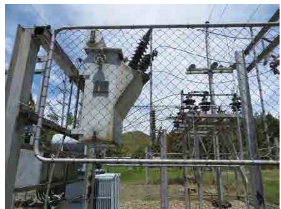
所内用変圧器
