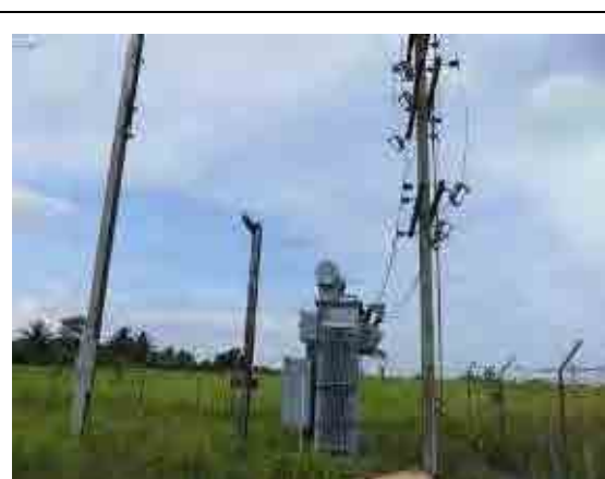
Nazdab 変電所内に設置の Nazdab 空港への 11kV 架空配電線路用の 1MVA 電圧調整器。
