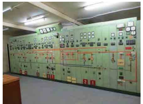
監視制御室 盤面の Mimic で Orange 色は 11kV 系統を表す。
