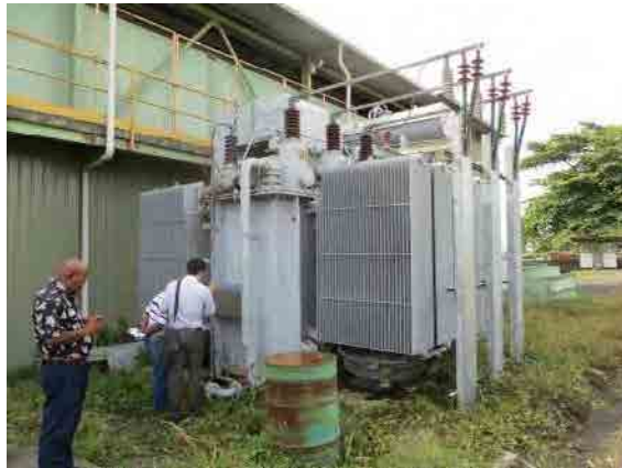
No.1 昇圧用変圧器、6.6/11kV、20MVA
