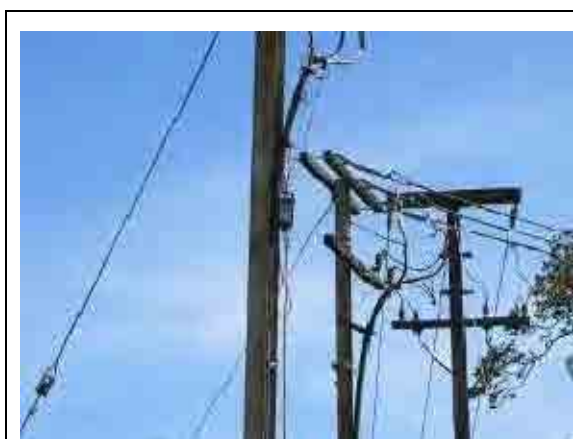
Milford 発電所の 11kV 配電線路引き出し点。 電柱は Steel 製。
