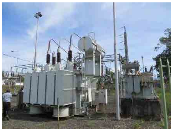
No. 1, 66/11kV 25/30MVA 降圧用変圧器
