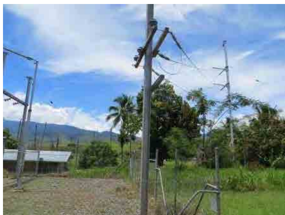
右奥に、建設途中で放棄した 132kV 送電線路用コンクリートポールがある。
