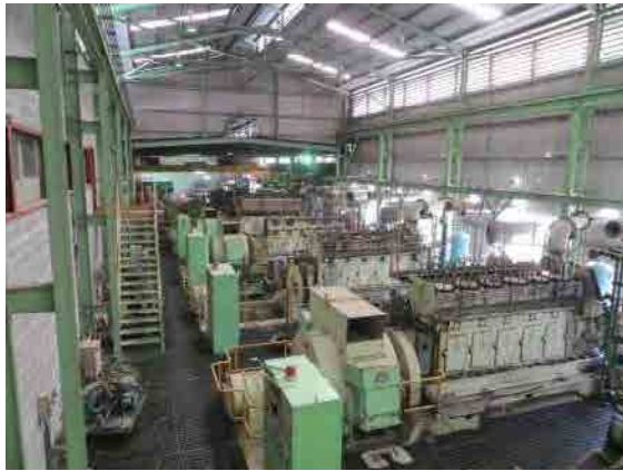
3.3MW DEG (6号機～11号機)、現有出力は2.5MWで運転しているのは6号機のみ
