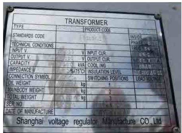
No.2 降圧用変圧器名盤
