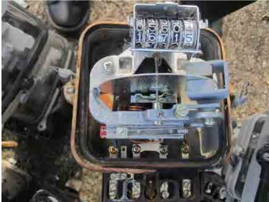
図 13 中国製メータの内部構造写真
