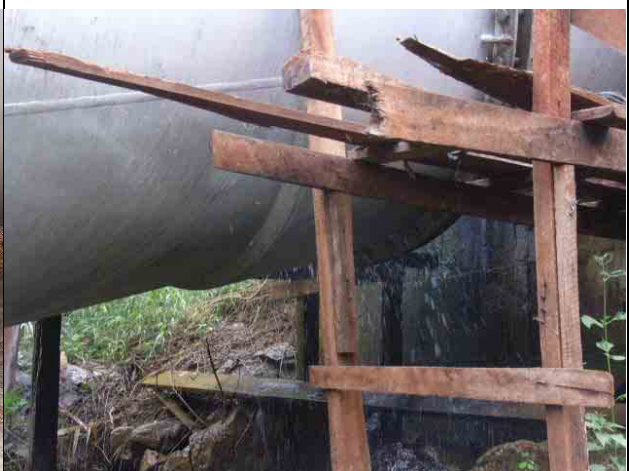
ペンストック漏水状況(追加要請)
