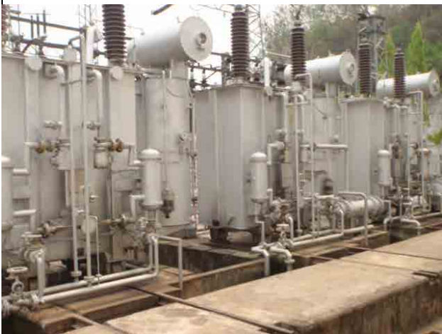
4号 132V 変圧器
