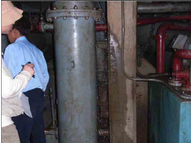
2号潤滑油冷却配管漏水(追加要請)
