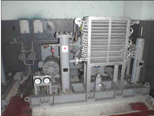
1~3号機用コンプレッサー(1/3期にて補修)
