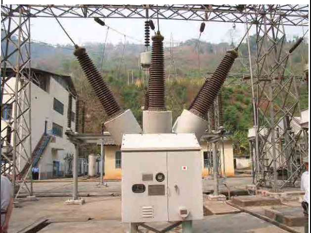
遮断器(1/3期にて増設)
