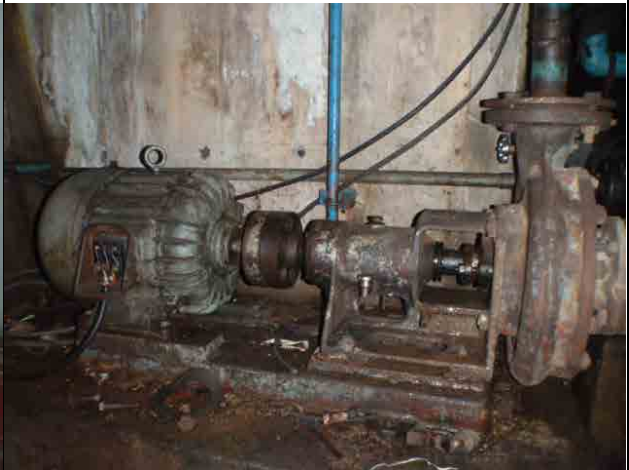
所内排水ポンプ
