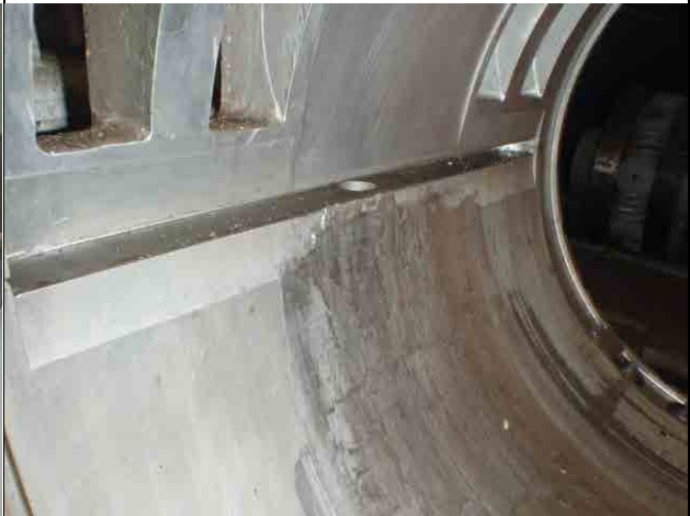
発電機軸受損傷(追加要請)
