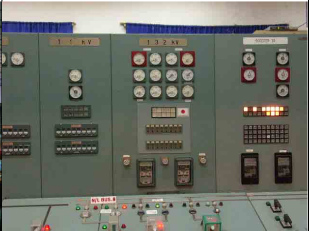
送電線計器盤(1/3期にて補修)
