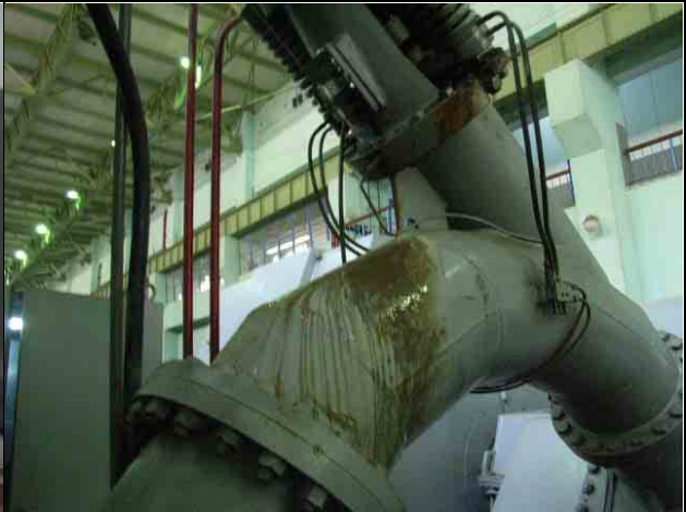
5号水車漏水(追加要請)
