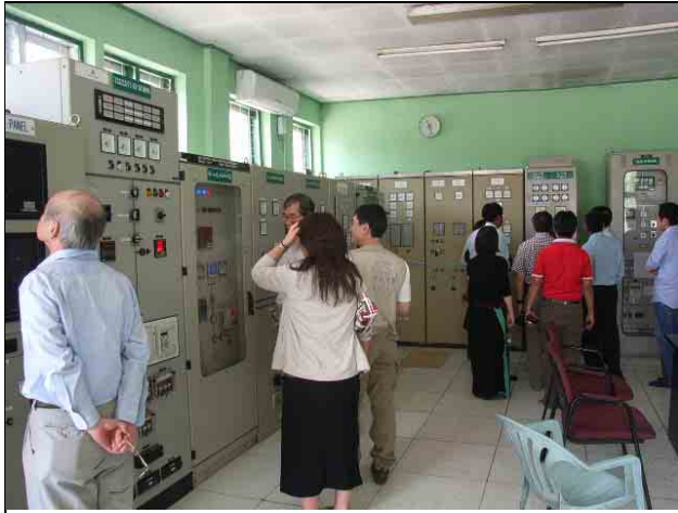
カロー変電所制御室
