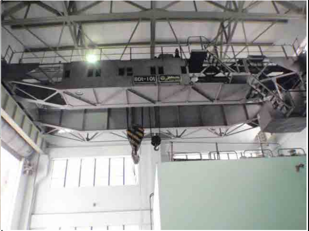
天井走行クレーン
