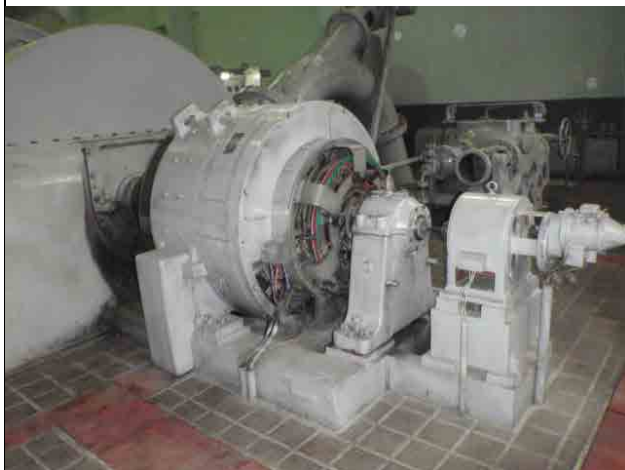
1号発電機励磁機
