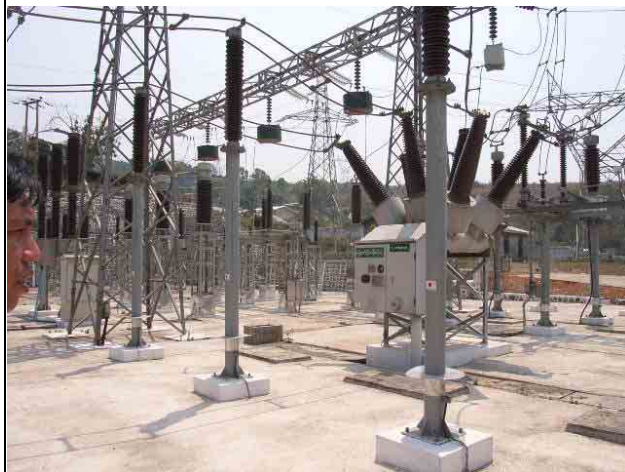
カロー変電所遮断器他(1/3期にて増設)
