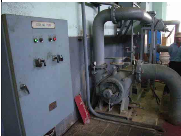
冷却水ポンプ設備(1/3期にて補修)
