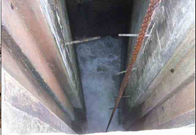
灌漑用水取水状況
