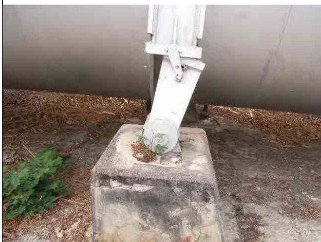
ペンストック基礎損傷状況(追加要請)
