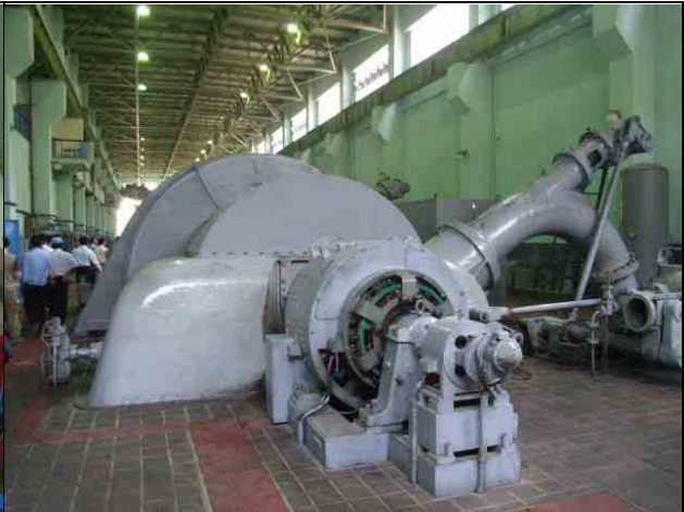
1号水車発電機
