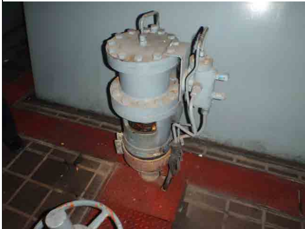
6号ジェットブレーキ故障中(追加要請)
