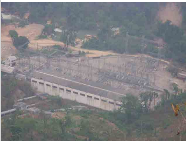
バルーチャン第二水力発電所
