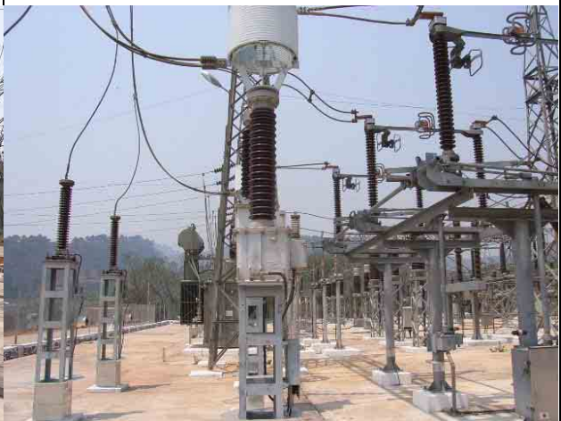
カロー変電所電圧変成器(1/3期にて増設)
