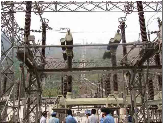
230kV シヤ断器
