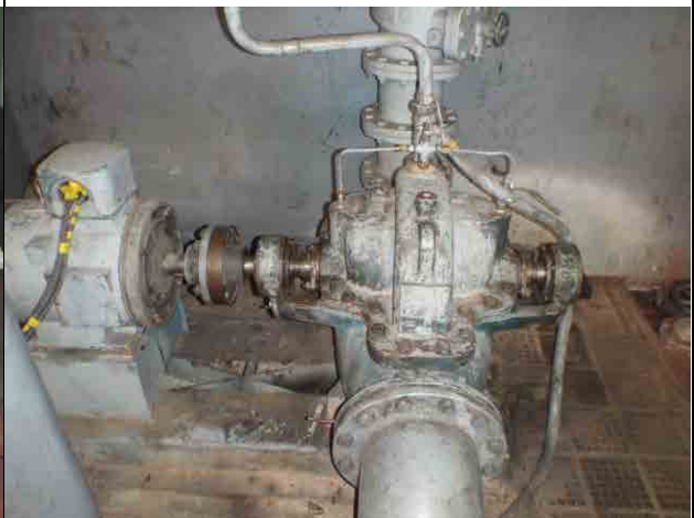
2号給水ポンプ(追加要請)
