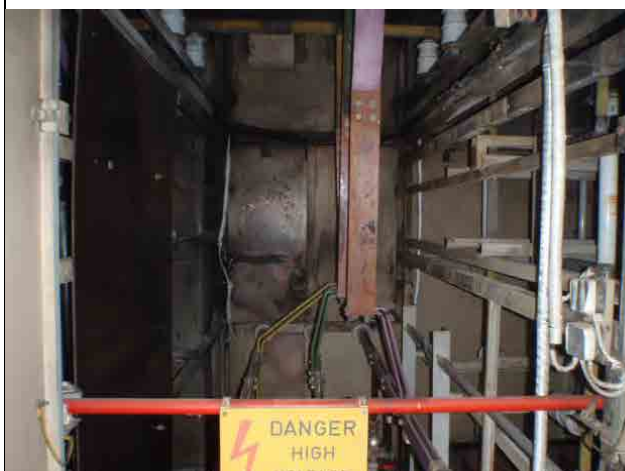
発電機用断路器損傷(追加要請)
