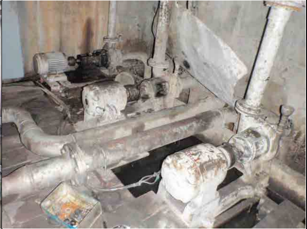
230kV 変圧器冷却水ポンプ
