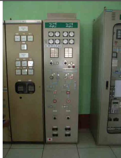
カロー変電所送電線制御盤(1/3期にて増設)
