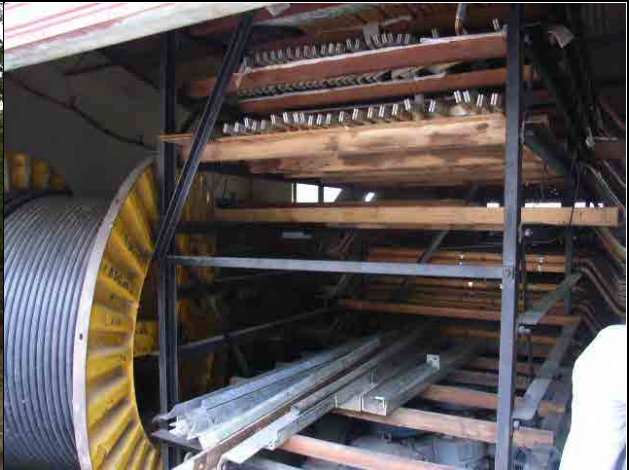
スペアパーツ保管状況
