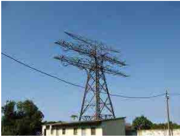
マトラに向かう 66kV 3 回線送電線
