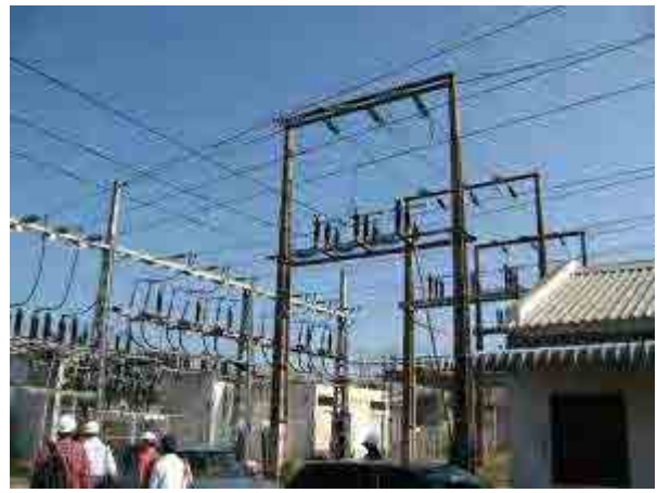
66/33kV 配電用変圧器と 33kV 配電線
