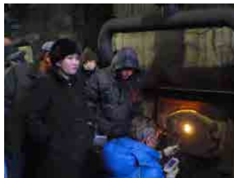
ボイラ効率測定の様子
