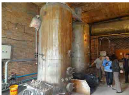
図-4-1-1: 温水ボイラ
