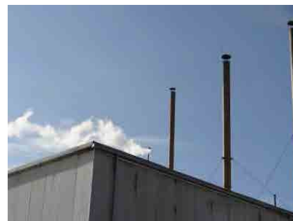
図-4-1-5 蒸気大気放出の状況
