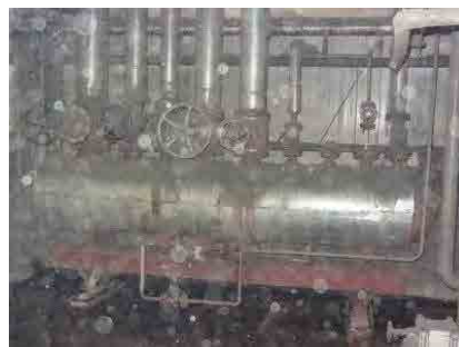
ボイラ出口蒸気 ヘッダー
