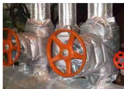
図-4-1-4 蒸気バルブ保温の実施例
