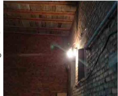
図4-3-5 ボイラ室の照明（白熱灯）
