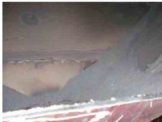
図－2 Hopper の灰残留状況
