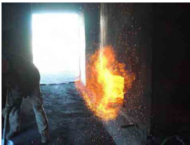
石炭投入口（炉内-Draft が低い）
