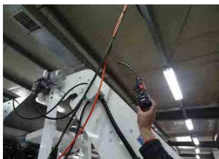
図-4-2-2 パッキングマシン廻りの圧縮空気漏洩検査の状況
