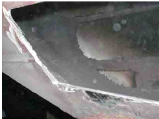
図 - 4 Hopper の灰残留状況
