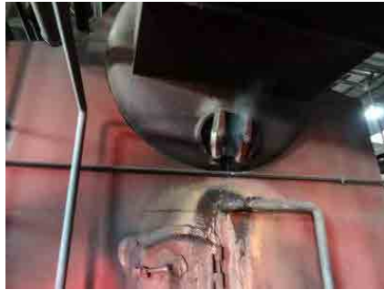
蒸気ドラムマンホールからの漏洩
