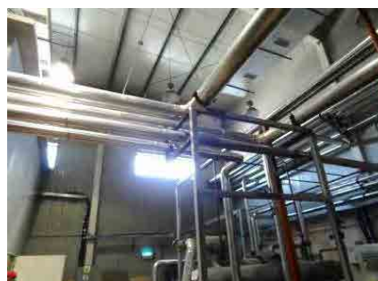
機械室の自然採光と消灯
