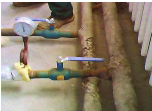
図-5-3-1: 製麺工場エアヒーター用蒸気ヘッダー
