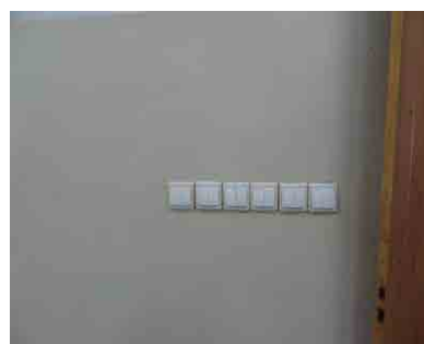
図4-3-4 照明スイッチ
