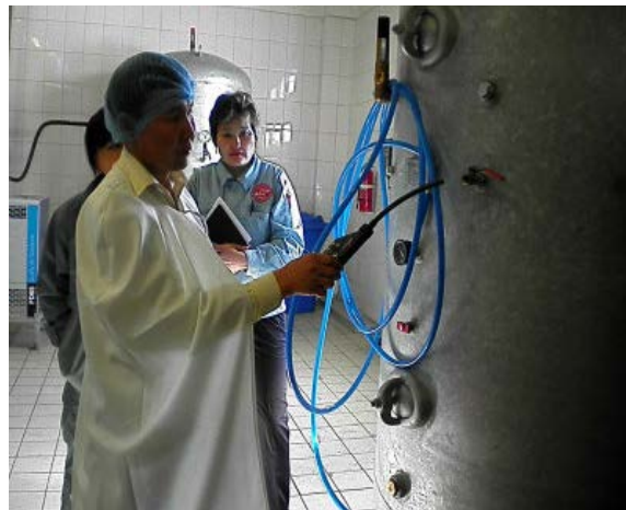
図 2.4-21 省エネルギー診断時の OJT 状況 (超音波漏洩検知器による圧縮空気の漏洩検知)
