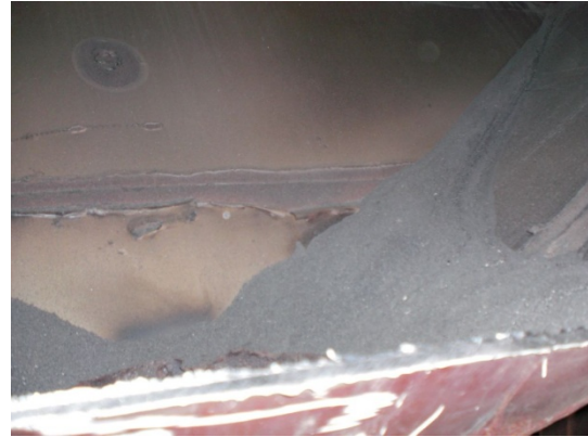
図 2.4-16b Hopper の灰残留状況
