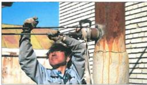
煙突に設置された測定孔
