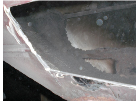
図 2.4-17b Hopper の灰残留状況
