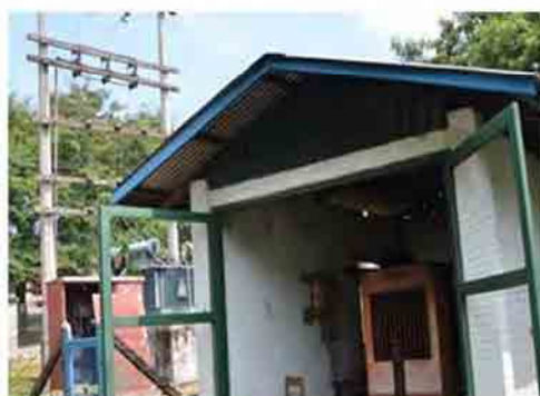
YAU電源供給変圧器+スタンバイ発電機
