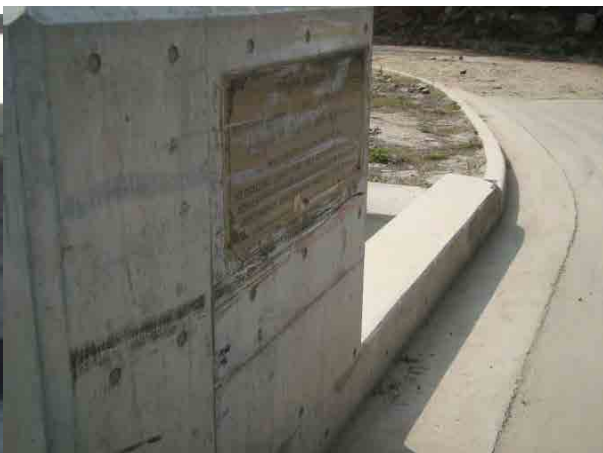
バスチュー橋の親柱 車両が接触し橋名版が破損している。
