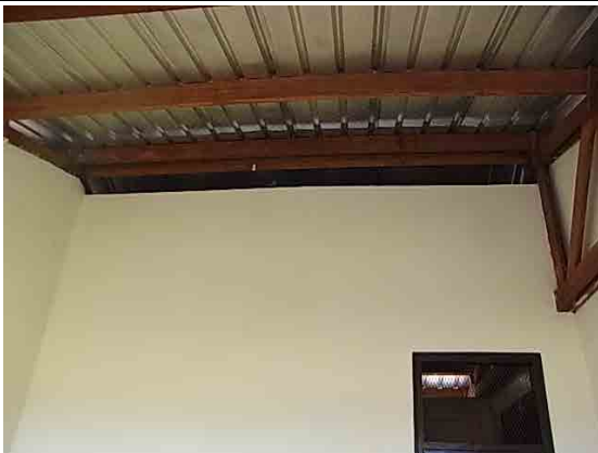
2-11 Begoua 校 (間仕切り壁)：セッション2 完工、引渡済 (2F8 教室 x2 棟、便所棟2、外塀) セッション3 着工 (1F3 教室 x1 棟)
