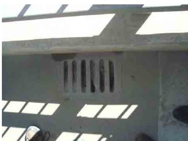
ラワカー橋の排水ます 砂塵が堆積している。
