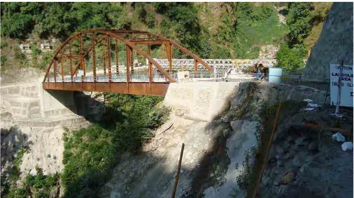
4-6 ローリン橋 鋼橋 L=70m 進捗 69.8%(2011年10月現在)手前道路補強工事施工中。
