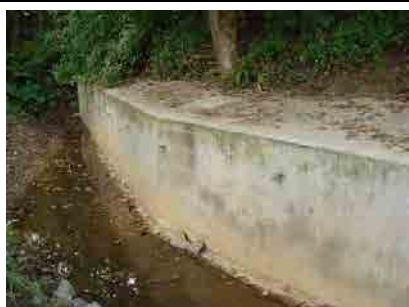
湧水集水用のコンクリート擁壁
