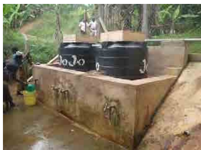
貯水タンクは1000lit.×2基
