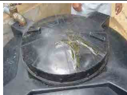
破損したタンク蓋
