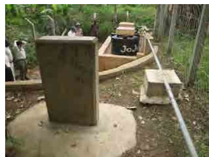
送水管支持の基礎が露出している
