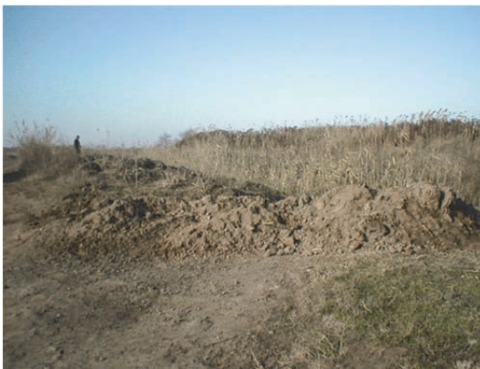
イミシュリ 機能喪失排水路 (掘削された堆積土砂とアシ繁茂)
