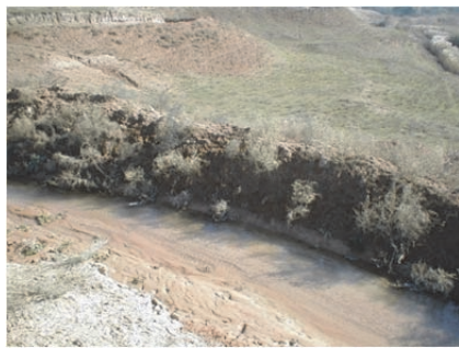
フィズリ アラクス川支流ミザカマリ川 灌漑施設 土砂堆積状況
