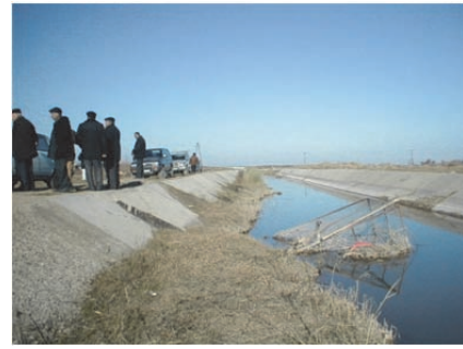
フィズリ ミル幹線用水路 ポンプ取水口付の近堆積状況
