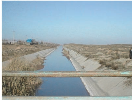
フィズリ ミル幹線用水路 堆積状況
