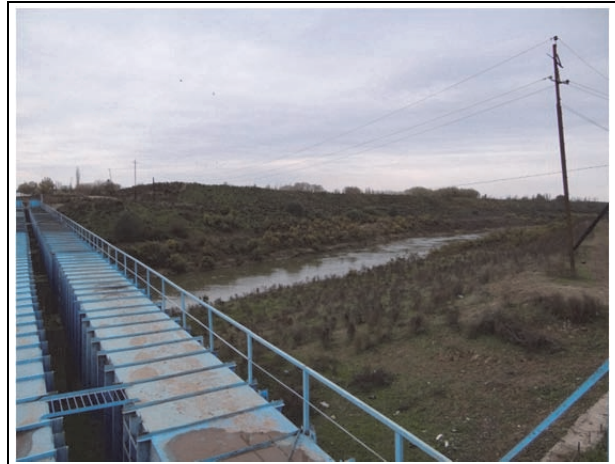
ミル・ムガン幹線排水路と幹線用水路 用水路が水管橋で排水路を横断している
