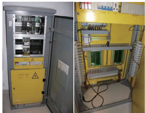
センターサーバ及びネットワーク機器
