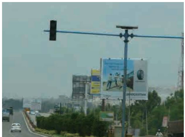
故障中の信号機
