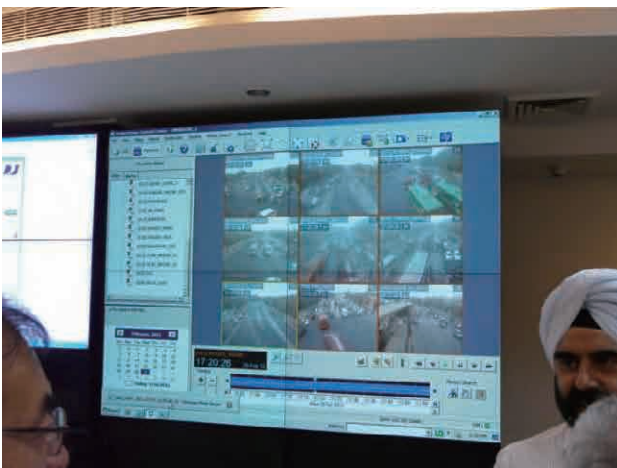
大型ディスプレイ（BRTS 路線 CCTV 映像監視）
