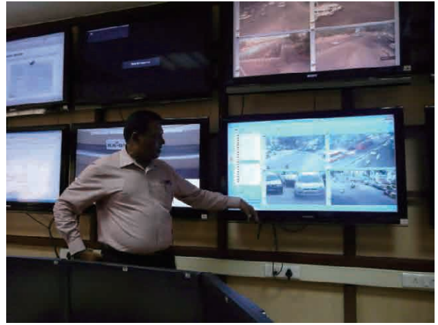
CCTV 監視モニター
