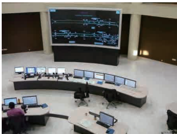
バンガロールメトロ コントロールセンター
