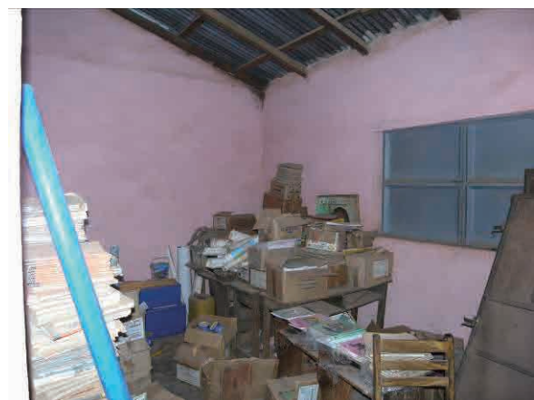
写真-12：校長室横の倉庫内部 教材、教科書等が保管されている No. 47 バトゥルー / D
