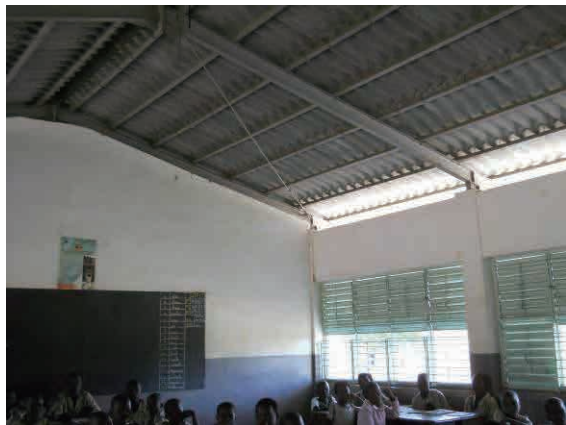
写真-31: 我が国の援助（第3次）による校舎内部 鉄骨屋根下地材を使用 アベオクペ, バシラ
