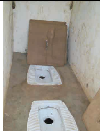
写真-32: 我が国の援助（第3次）によるトイレ内部 第2次とは違い、陶器の便器が設置されている EUC クアンデ / B, クアンデ
