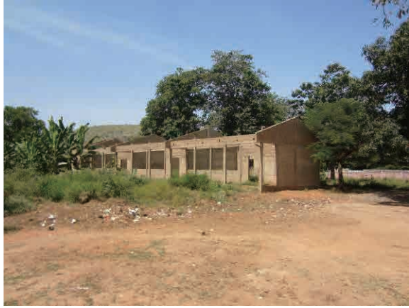
写真-19：政府の PCRESC-EPP プロジェクトによる建設工事が中断したまま放置された校舎-1 No. 26 ヨコシ / C, ナティティンダ
