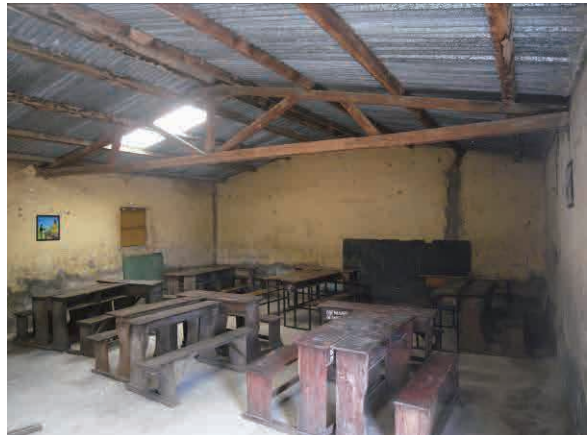
写真-6 : バンコ (日干し煉瓦) の校舎内部 窓が小さいため、天井から採光を取っているが、換気が不十分。No. 34 マモサ, タンギエタ
