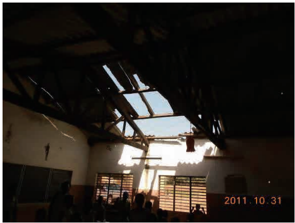
写真-9：スレート屋根に大穴があいた教室 ナティティング
