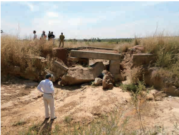
写真-21：アクセス途中の橋が今年の雨季に落ちた場所 No. 42 トミ, コパルゴ
