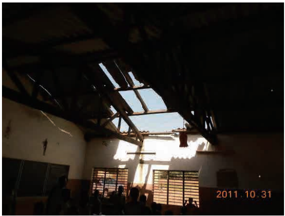
写真-9：スレート屋根に大穴があいた教室 ナティティグ
