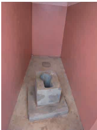
写真-35: 我が国の援助 (第4次) のトイレ内部 腰掛式の便器 ゾウンタ / B, ダンボ, ウエメ県
