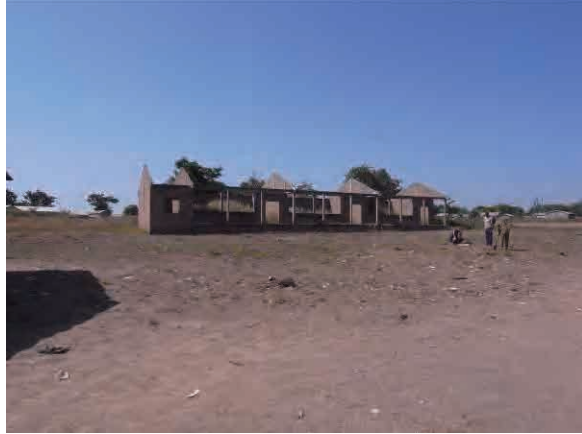
写真-20：政府の PCRESC-EPP プロジェクトによる建設工事が中断したまま放置された校舎-2 No. 55 バクフォワ / B, ジョグー
