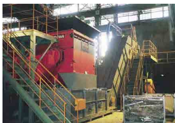
写真 5.1-5 廃プラスチックの破砕機
