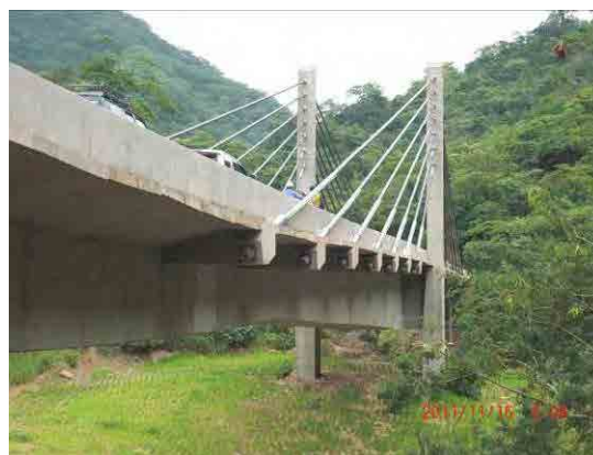
Medida de desvío por puente
