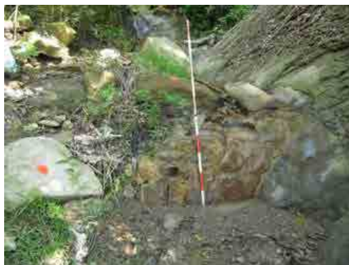
Figura 2-13 Presa de retención del Punto07-03
