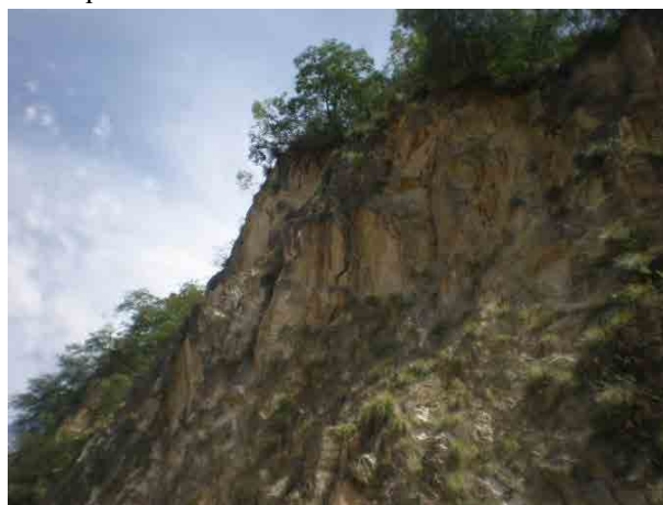
Rocas con grietas verticales en la parte superior
