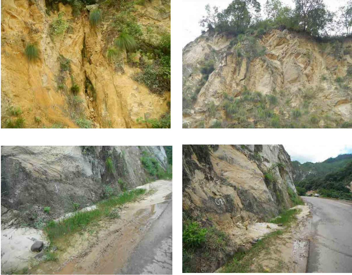
Figura 2-10 Estado del talud en el Punto 07-02 después de la época de lluvias
