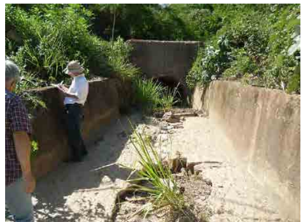
Figura 2-16 Estado del canal trapezoidal de hormigón de la parte aguas abajo
