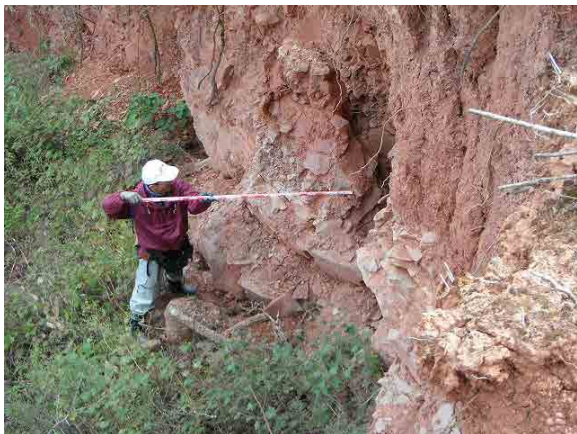
Rocas sedimentarias no consolidadas que se encuentran en la línea de escarpa Aparición de grietas
