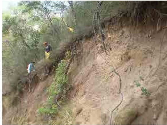
最上部の旧崩壊跡、h=3~5mの崖線
