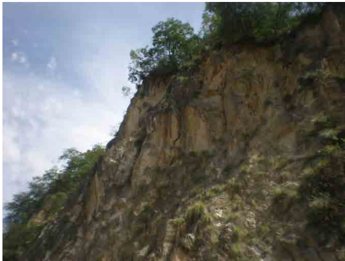
上部の岩盤、縦亀裂あり
