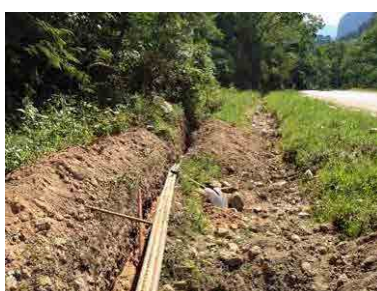
埋設標示テープ
