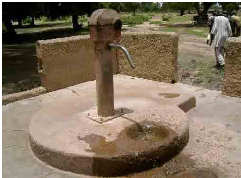
写真-9 故障修理中の ABI 型人力ポンプ クルウェオゴ県 Sourgoubila コミュニティ Natenkodogo 地区の 1985 年建設の ABI ポンプ。10 日前から修理中。成人男性 1000Fcf、女性 500Fcf を年 1 回徴収している。
