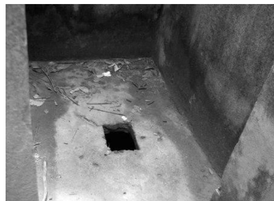
左記の簡易ピット式トイレの排泄口
