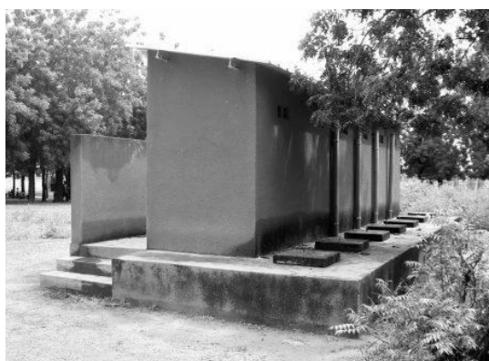
日本の無償資金協力（1998年） による小学校の二槽式VIP
