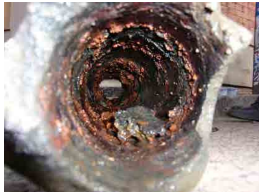
Borella 老朽CI管内部
