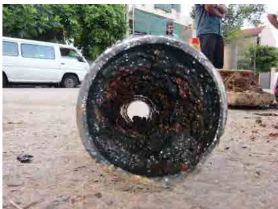
Borella 老朽CI管内部
