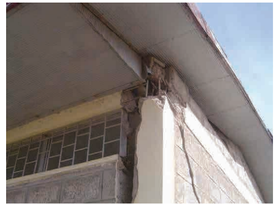
S-3 建設サイト隣接小学校（地震の影響で教室棟にクラックが入っている）
