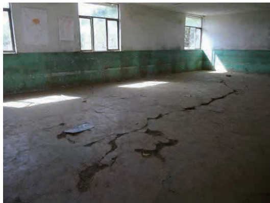
P-7 大きなクラックの入った教室内部の様子
