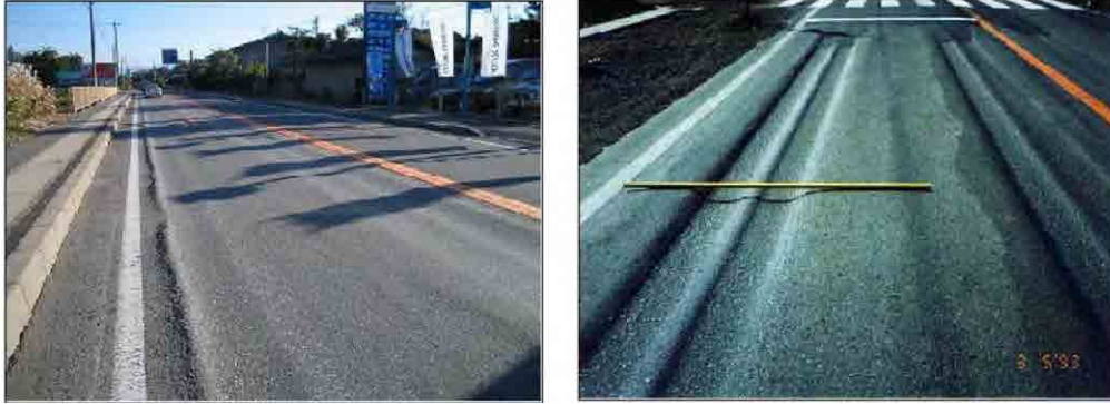
図 5-4 わだち掘れの事例
