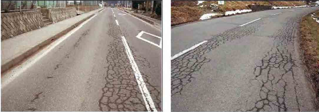
図 5-7 ひび割れの事例
