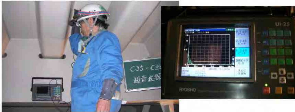
図 5-30 超音波探傷試験による鋼床版の亀裂調査の例
