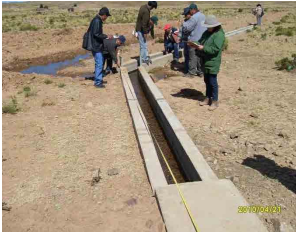
ラパス県パタカマヤ市 Cala Cala 村落の水路 (集水渠による伏流水取水)
