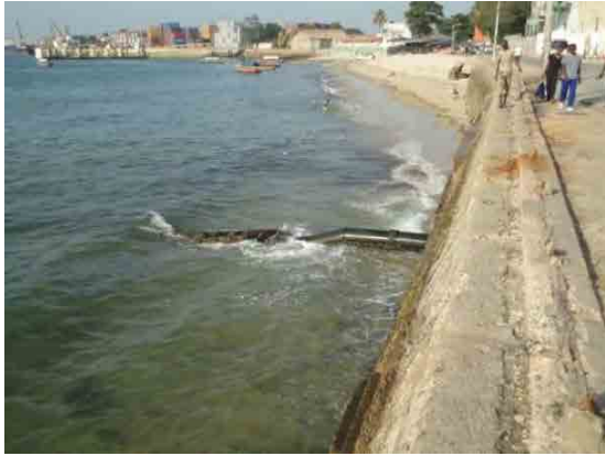
(13) ミジンガニ道路 (Mizingani Road) 沿いの雨水排水の海中放流管
