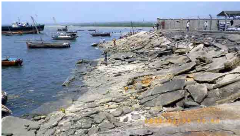
崩壊したスロープ式岸壁の状況
