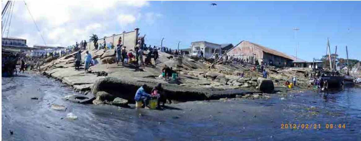
崩壊した護岸（左手）とスロープ式岸壁（右手）。干潮時に干出した海底から見上げた状況
