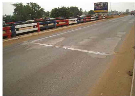
ダブル橋 既存道路側のダブル橋の状況である。 橋面の舗装が無く、コンクリート床版が露出して おり、補修及びメンテナンスが必要である。
