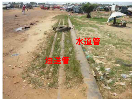
4km+50付近 水道管(16インチ)や油送管が露出している。 現在水道管は使用しているが、油送管は 使用していない。
