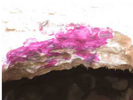
写真 2-スラブでの調査結果、上端部から朱色に変わっており、中性化は起こっていない
